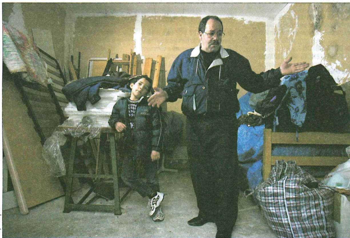
Dans l'impossibilité d'utiliser les chambres imbibées d'humidité du 1 er étage (ci-dessus), la famille Zenati, six enfants et deux adultes, s'est réfugiée dans deux petites pièces, aussi insalubres, situées au rez-de-chaussée.
